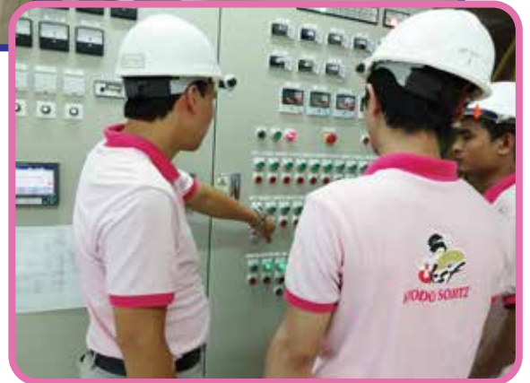
Thường xuyên kiểm tra hệ thống máy móc
